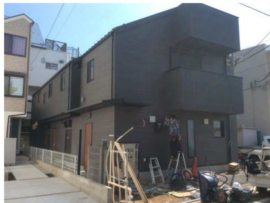
◆木造2階建賃貸併用住宅 目黒区大岡山 (2017. 3月竣工)
